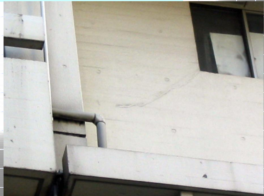
外壁ひび割れ
